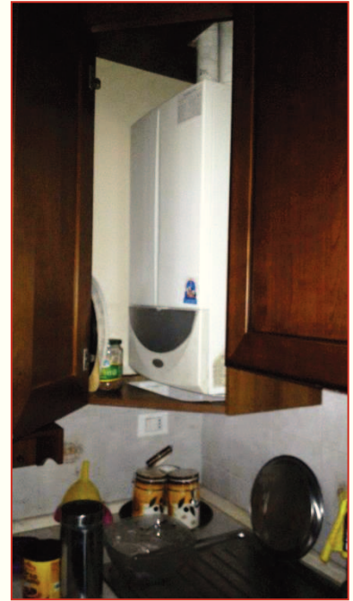
FOTO: particolare caldaia autonoma
